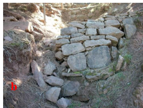
Figure 8 . a . Seuil en pierres sèches non endommagé ; b . Seuil en pierres sèches moyennement endommagé
