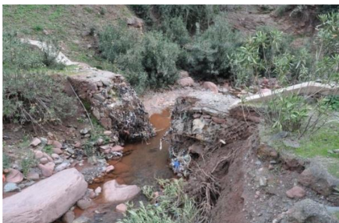
Photo 6 : Seuil en gabion partiellement détruit ne jouant plus correctement son rôle
