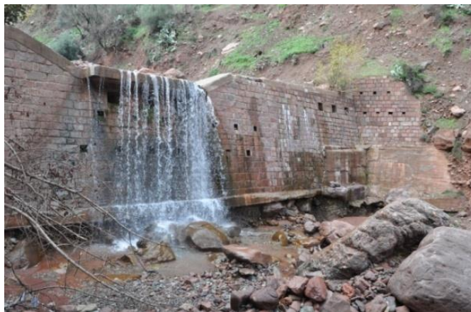
Photo 5 : Seuil en maçonnerie fonctionnel avec un radier complètement endommagé, risque d'affouillement de l'ouvrage
