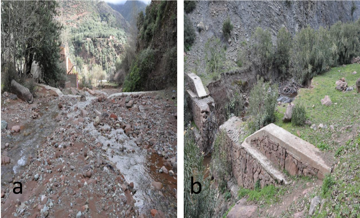
Photo 2 : Etat des dépôts sédimentaires en relation avec l'état des seuils. a : seuil en bon état ; b : seuil en destruction
