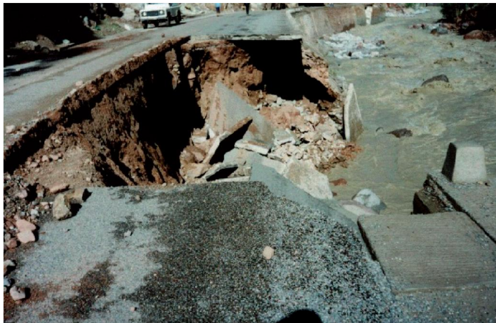
Photos 16: Mur de soutènement de l'Ourika détruit par la crue du 28 octobre 1999
