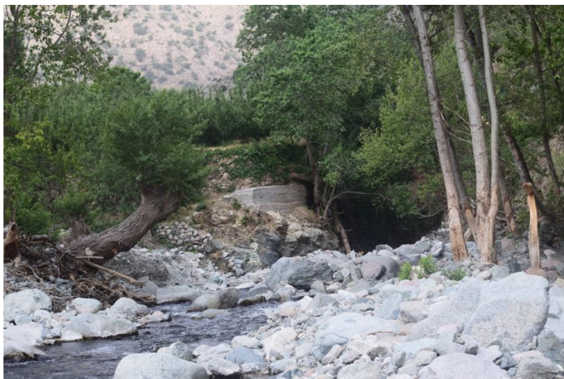
Photos 6: Les dégâts d'inondation existent à ce jour-là dans la zone
