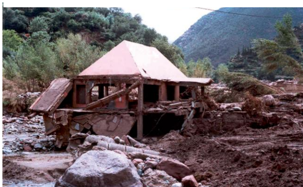
Photos 14: Habitation édifée près du lit de l'oued et détruite par la crue du 17 août 1995
